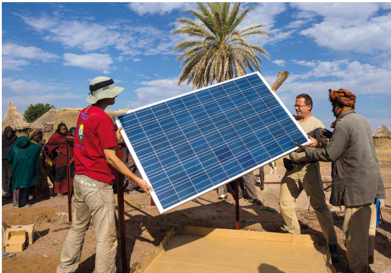
Les panneaux photovoltaïques ont l'avantage d'apporter la lumière dans les villages reculés. Deux entrepreneurs africains vont être formés par l'entreprise wallonne Enersol © DR
